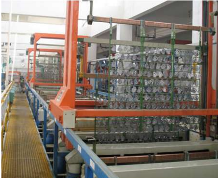
29. ábra Galvanizáló sorról készült fénykép: tartó keretre függesztett alkatrészek kezelése
